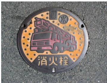
地下に埋設された消火栓の例
